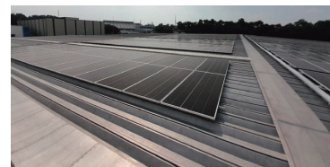
インドネシア工場の太陽光パネル
